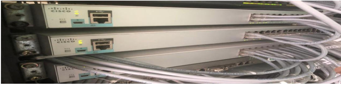
Gambar 12 . Pemasangan 3 Unit Perangkat Cisco Gigabit Tipe C2960L di Rak Server UPT. TIK
